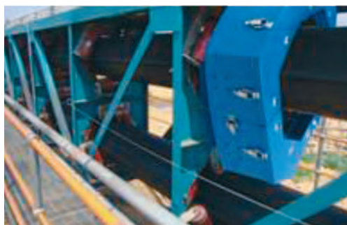
Рис. 4. Установка системы контроля ленты трубчатого конвейера, китайской компании «Shanxi Dedicated Measurement Control»
