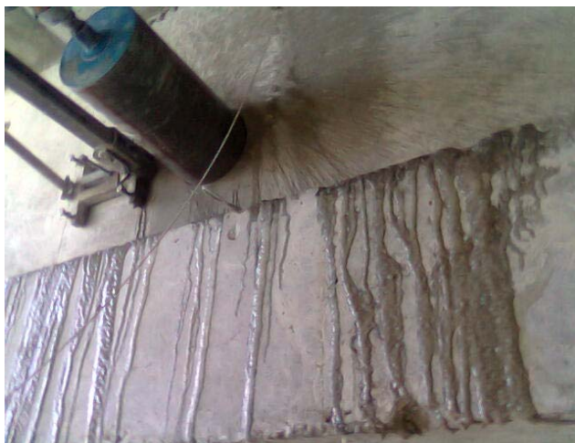
Рис. 1. Обледенение конструкции при бурении технической скважины в железобетоне
