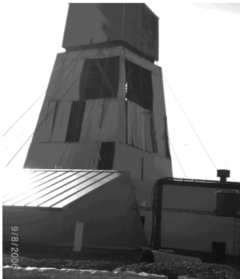
Рис. 2. Разрушение обшивки копра на стволе ВВС рудника «Удачный»
