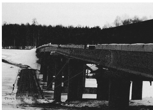
Рис. 4. Деформация мостового перехода через реку Сосьва
