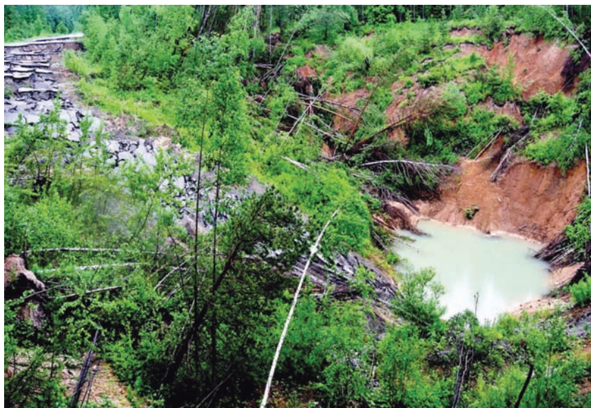
Рис. 2. Фактическое состояние зоны обрушения и бывшей автодороги
