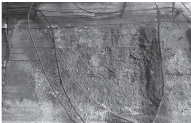
Рис. 1. Зона деструктивного бетона обделки площадью около 5 м 2 , глубиной до 70 мм Fig. 1. The area of destructive concrete lining with an area of about 5 m 2 and a depth of 70 mm
