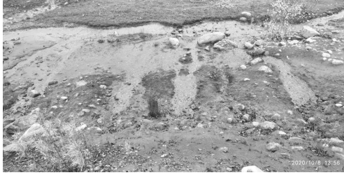
Рис. 4. Выходы воды у подножия дамбы Fig. 4. Water outlet at dam bottom
