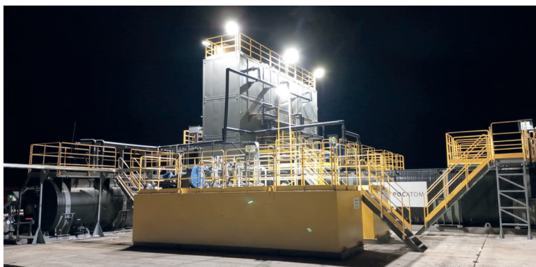
Рис. 2. Мобильная сорбционная установка Fig. 2. Mobile sorption plant
