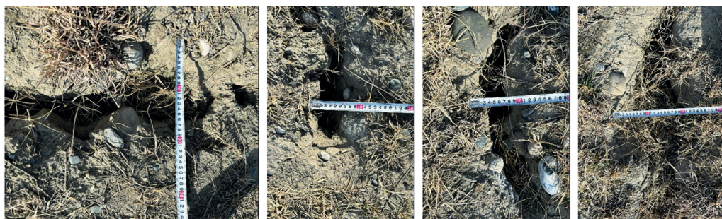
Рис. 2. Фото обнаруженных деформаций рекультивированной поверхности Fig. 2. Photo of detected deformations of the reclaimed surface
