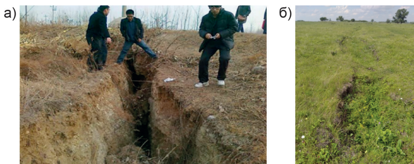
Рис. 3. Трещины сдвижения на поверхности шахтных полей: на поле шахты Хуафэн (а); на поле шахты им С.М. Кирова (б)
